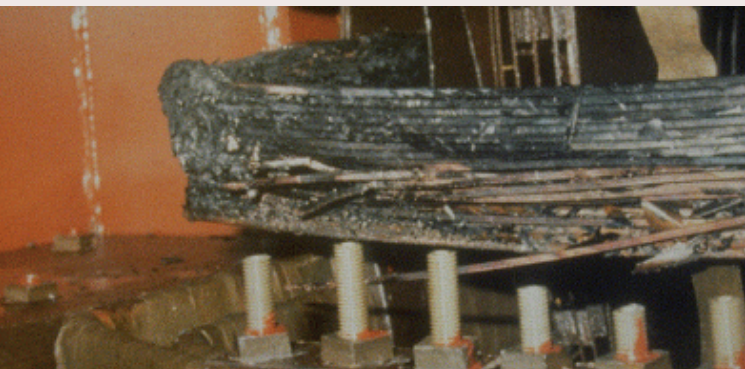
Deteriorarea unui transformator electric în Salem, New Jersey, SUA – J.G. Kappenman
